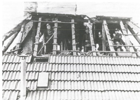
Dachstuhlbrand Oeffinger Str.
