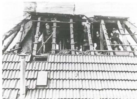
Dachstuhlbrand Oeffinger Str.
